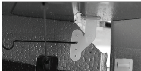
Antenna di controllo dell'elevatore
